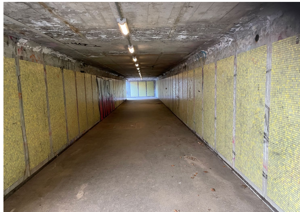
↑ FIGUR 17 Fodgængertunnelen under Blegdamsvej fremstår utryk og for sømt. Forslag til forbedringer kunne indebære tryghedsskabende belysning og en grundig gennemgang af stand og materialitet af gulv, vægge og loft. Foto: MOE
